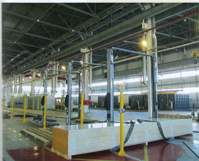
В недавно построенном цехе завершается подготовка к работе линии для сборки кабин. Монтируется современное катафорезное оборудование.
